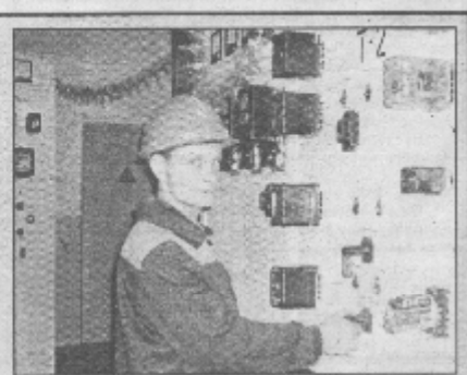
электропроводов и электрооборудования, аппаратов защиты от аварийных режимов на вновь вводимых линиях «Решал», «Вексел», «Грида». Проведены замеры на предприятии, поселка и в учреждении управления культуры. На подстанции по ул. Украинская заменены части оборудования 1949 года выпуска для защиты линий от перегрузки. Эта подстанция находится на оперативном обслуживании опытных электромонтеров. Искренне, Владимир Владимирович Зыков (на снимке) – 10 лет.
