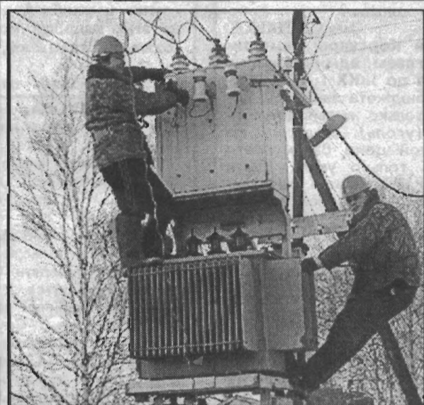
Николай ТУРБУЕВ и Андрей АНДРЕЕВ - монтажники распределителей, занимаются обслуживанием трансформаторов и воздушных линий электропередач.
