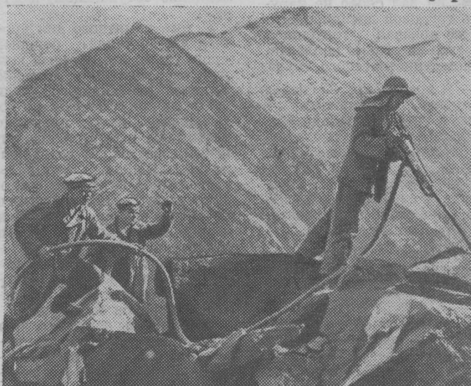
Трудно строить дорогу на большой высоте, над самой рекой. Рабочие взрывают скалы, и огромные глыбы летят с вы-
