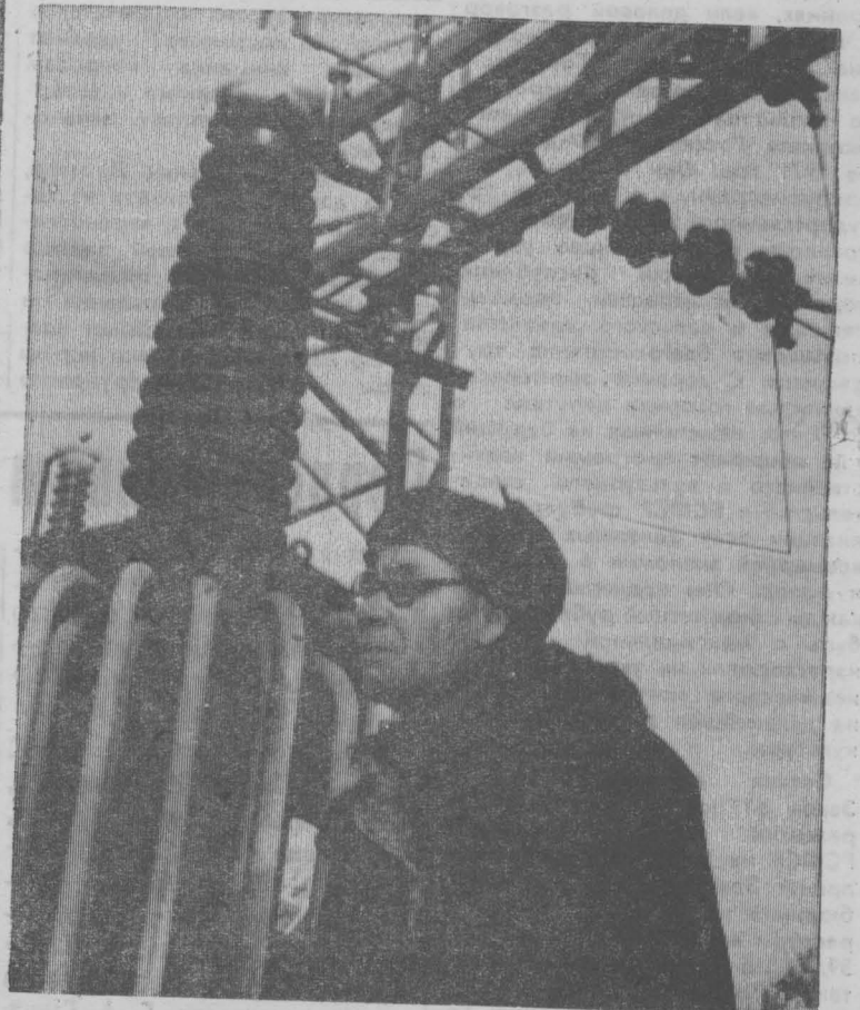
НА СНИМКЕ: дежурный подстанции 10-го сетевого участка А. И. Федосеев наблюдает за состоянием измерительных приборов.
