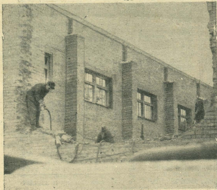
Недавно я сообщал о рационализации строителей из СУ-1 треста «Кемерово-Химстрой», забывших в спешке балки перекрытия и крышу на 966 корпусе сделать. Этот снимок — свидетельство голловотпства.
