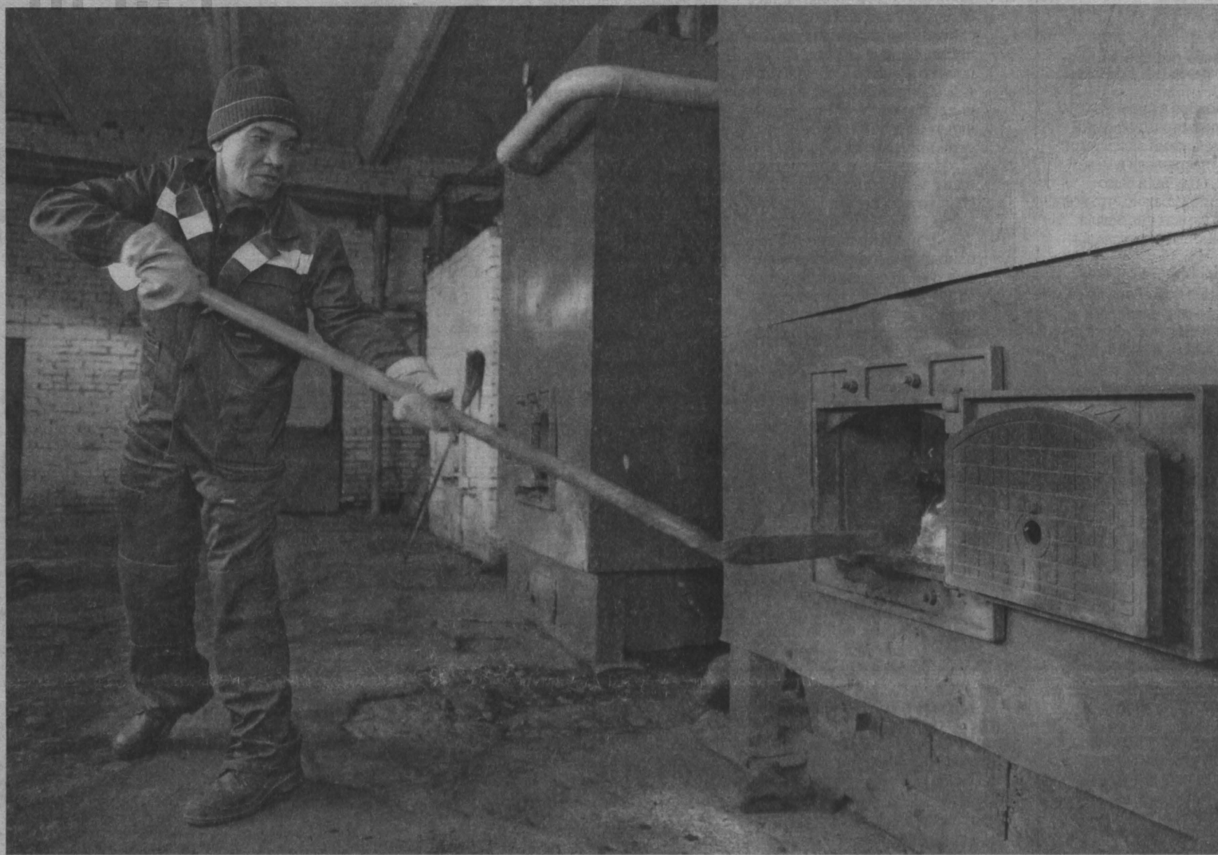
Котельная №9 посёлка Тисуль работает на буром угле всю зиму, бесперебойно снабжая теплом объекты социальной сферы. Фото Сергея Гавриленко.
