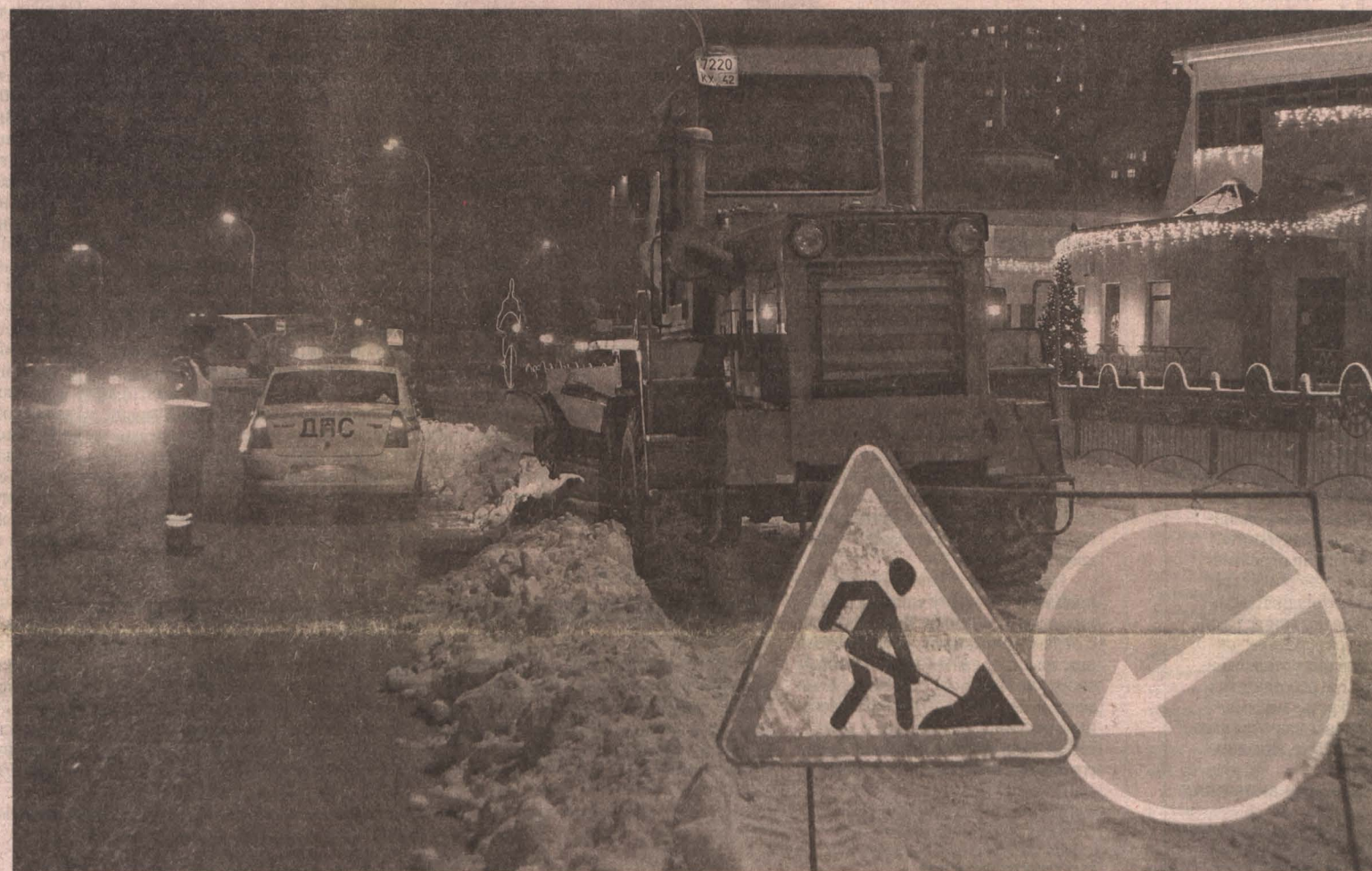
Плохо убранные от снега и наледи дороги нередко создают риск ДТП с тяжелыми последствиями. Фото Андрея Третьякова.
