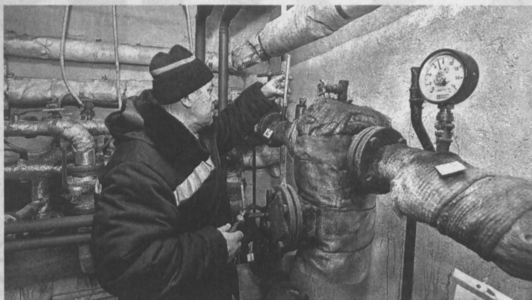
■ В Кузбассе поставлена задача установить общедомовые счетчики во всех домах, а не только в новостройках. Фото Федора Баранова.
