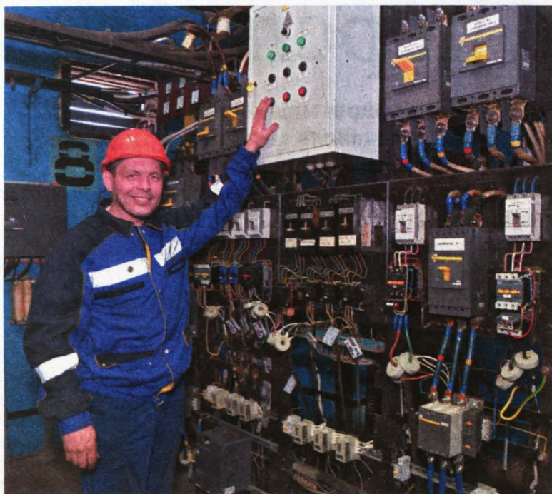
■ Настройка щита управления подпиточными насосами. Электрослесарь по ремонту и обслуживанию 4-го разряда Владлен Александрович Янькин.
