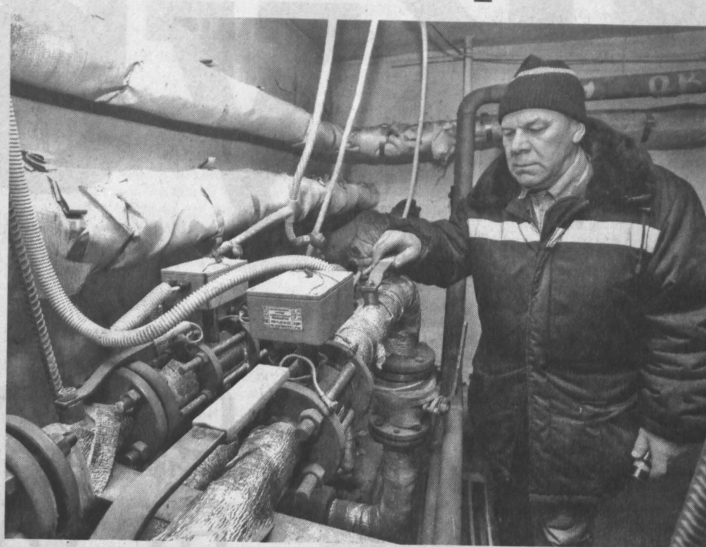
■ Дом на улице Молодежной, 4а, в Кемерове тоже обеспечен общедомовым счетчиком тепла. Фото Федора Баранова.
