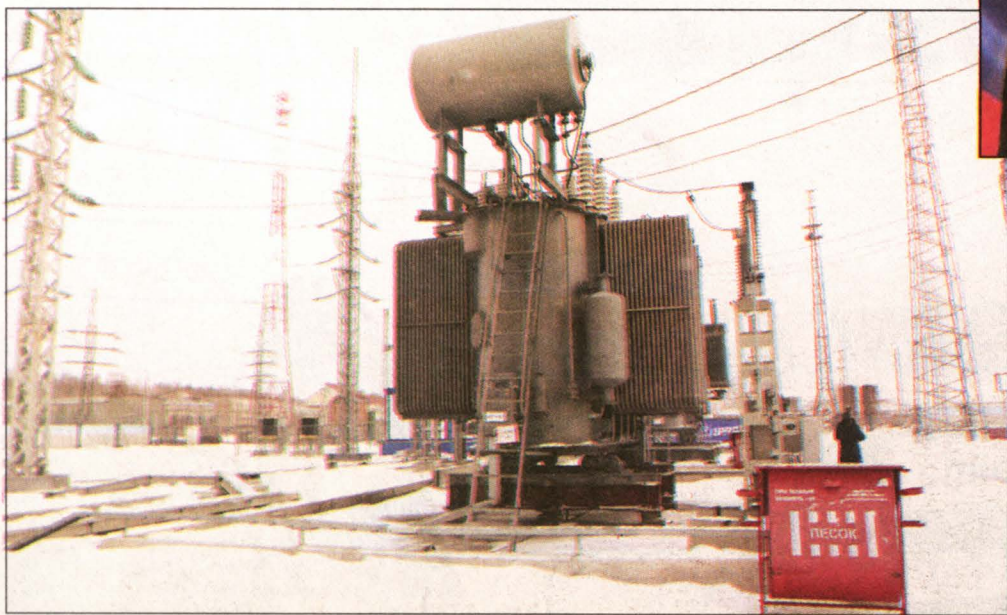
Оборудование подстанции отвечает самым современным требованиям.
