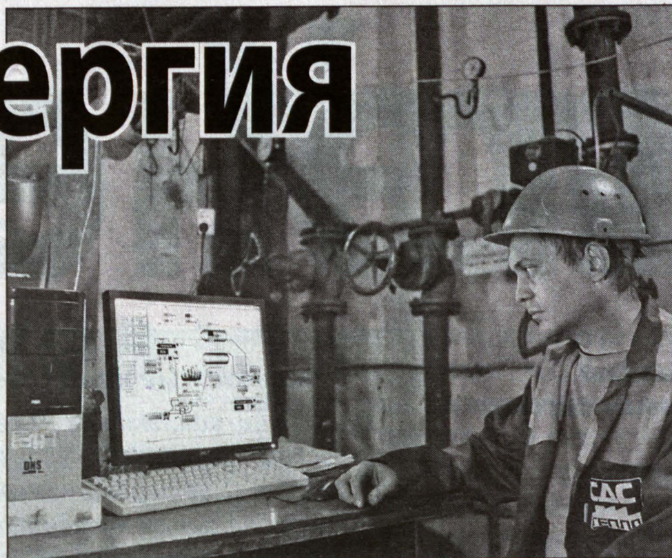
Модернизированный котел №4 (система управления).
