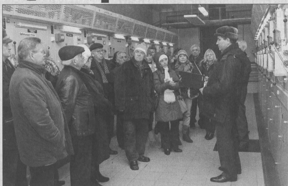
Современный распределительный пункт.
