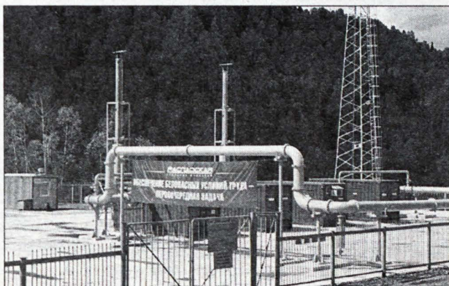
Дегазационные установки строящейся шахты «Распадская-Коксовая».
