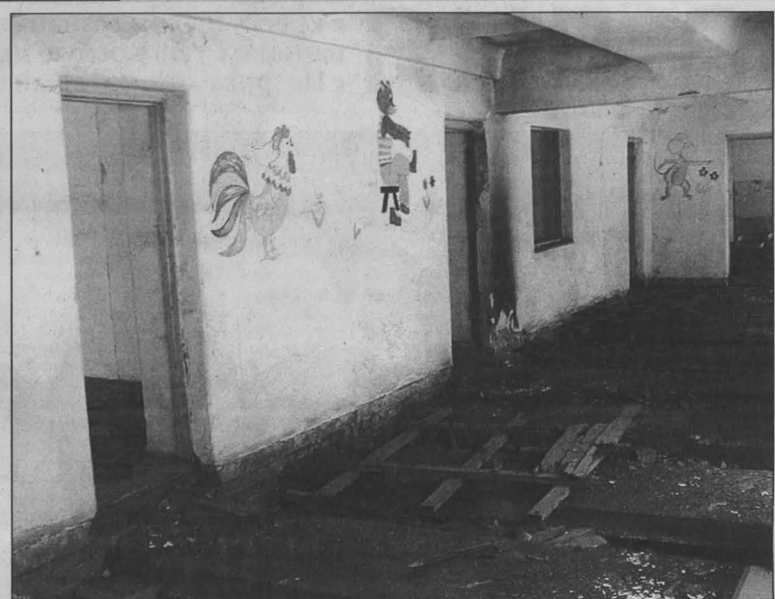
Когда-то здесь была лагерь треста «Кузнецкпромстрой» под Сосновкой. А сейчас стоят ободраные корпуса, вырваны оконные и дверные блоки, разобраны полы и сантехника... Фото Сергея Былинкина.
