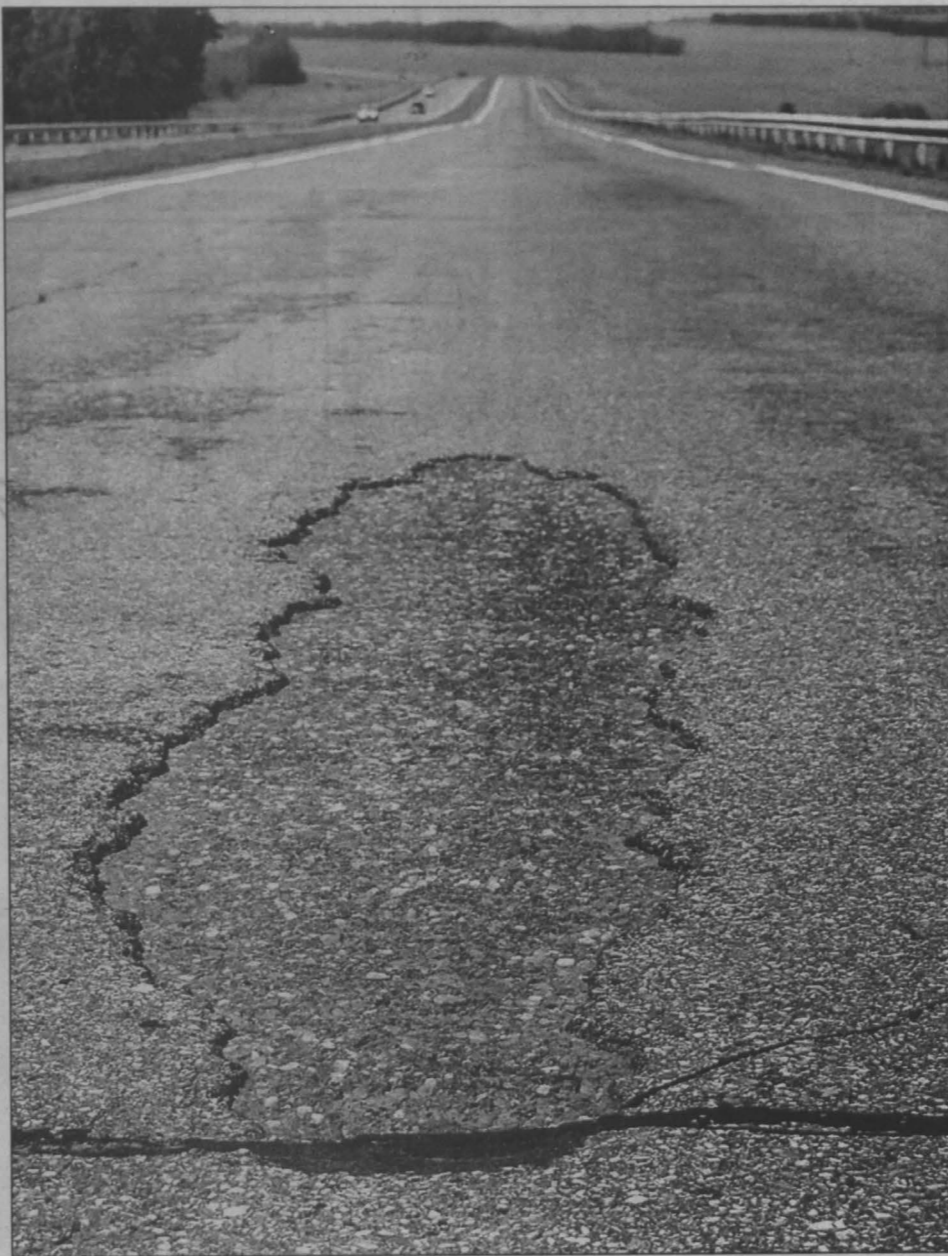
Ямы на проезжей части даже знаменитой дороги первой технической категории Ленинск-Кузнецкий - Новокузнецк, становятся привычным делом.
