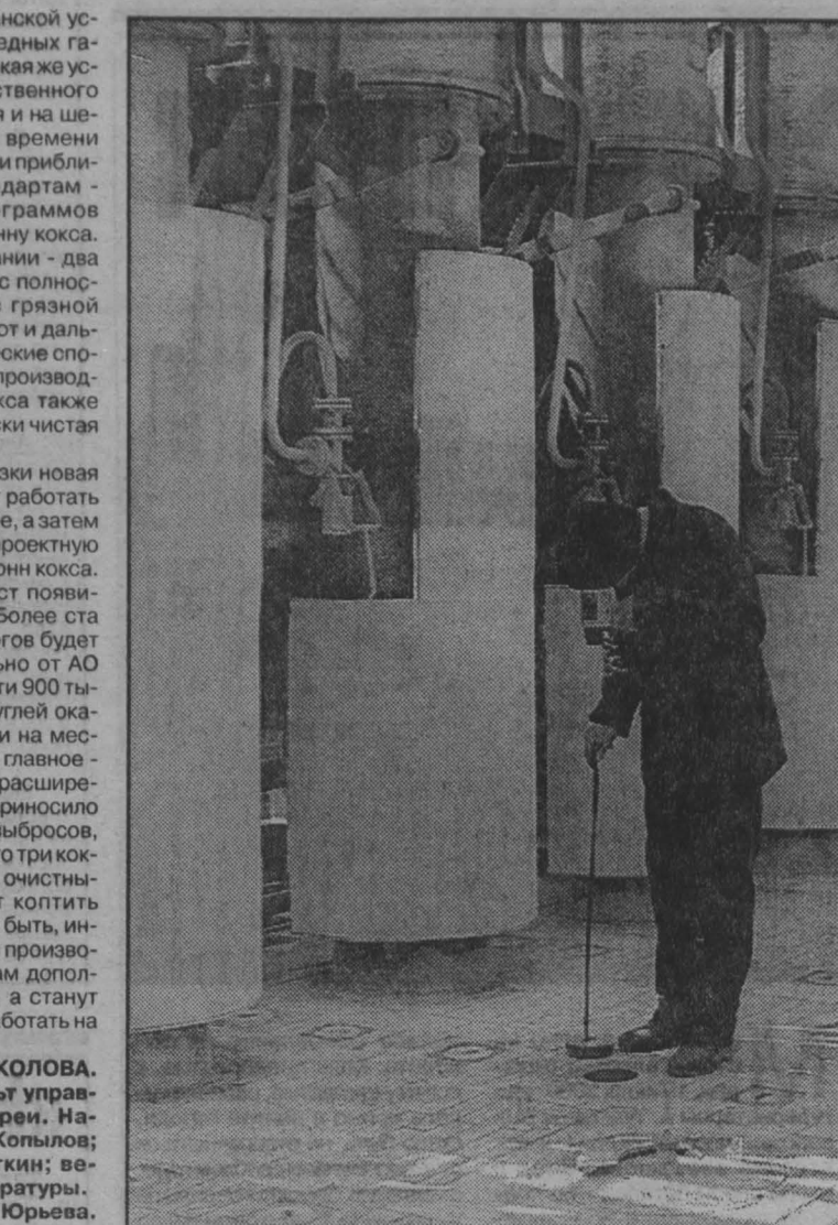
Татьяна КОЛОКОЛОВА. НА СНИМКАХ: пульт управления коксовой батареи. Начальник участка В. Ю. Копылов; монтажник А. П. Кураткин; ведется контроль температуры. Фото Юрия Юрвева.
