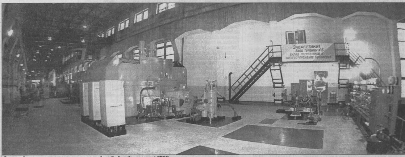
Сегодня будет запущена в эксплуатацию турбина № 5 на Кемеровской ГРЭС.
