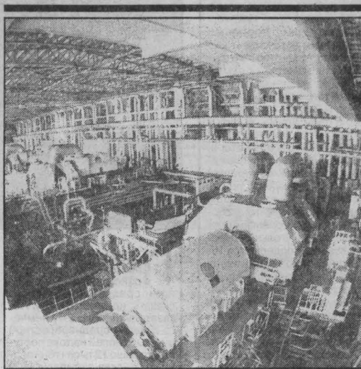
Турбинный зал Томусинской ГРЭС
