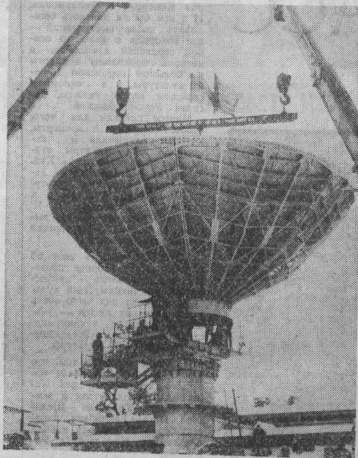
При техническом содействии Советского Союза в городе Хошимин закончено сооружение наземной станции космической связи «Потос-2»...
