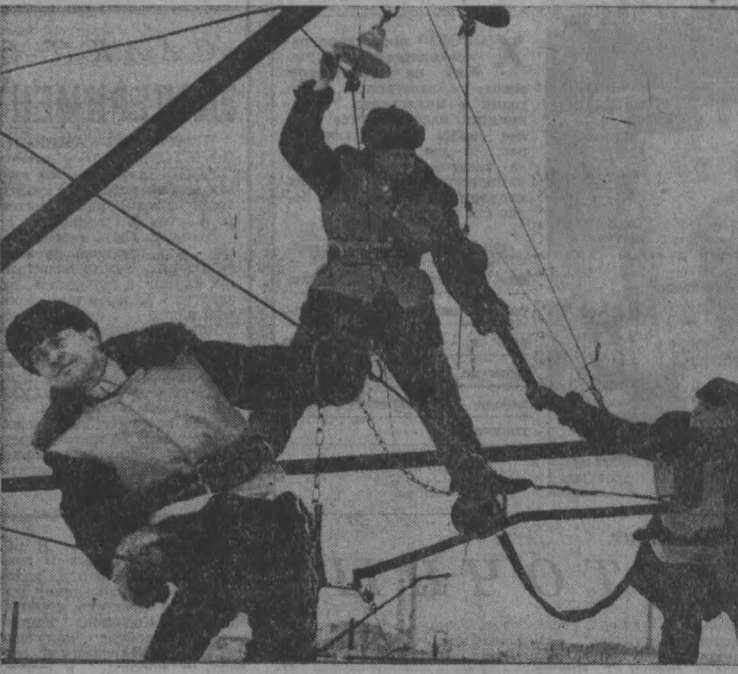
БРИГАДА кавалера орденов Октябрьской Революции и Трудового Красного Знамени Николая Диньтривича Сидорова обслуживает станцию Новокузнецк-Восточный. Благодаря работам передового коллектива контактная сеть здесь всегда в хорошем состоянии. НА СНИМКЕ: Н. Д. Сидоров (в центре) проверяет состояние контактной сети. Фото Г. Нефедова, г. Новокузнецк.
