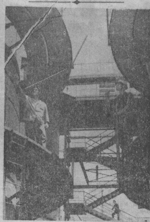
БОЛГАРИЯ. В Девинской долине близ Варны строится крупнейший в Европе комбинат по производству химических удобрений (на снимке). В его сооружении принимают участие Советский Союз и другие страны — члены СЭВ.
