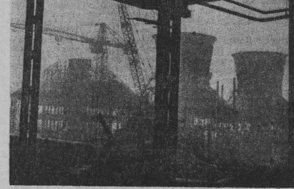
Строится третья очередь комплекса капролактама на Ново-Кемеровской химкомбинате. Здесь монтажники нужно уложить десятки километров трубопроводов различных диаметров, установить и смонтировать много оборудования.
