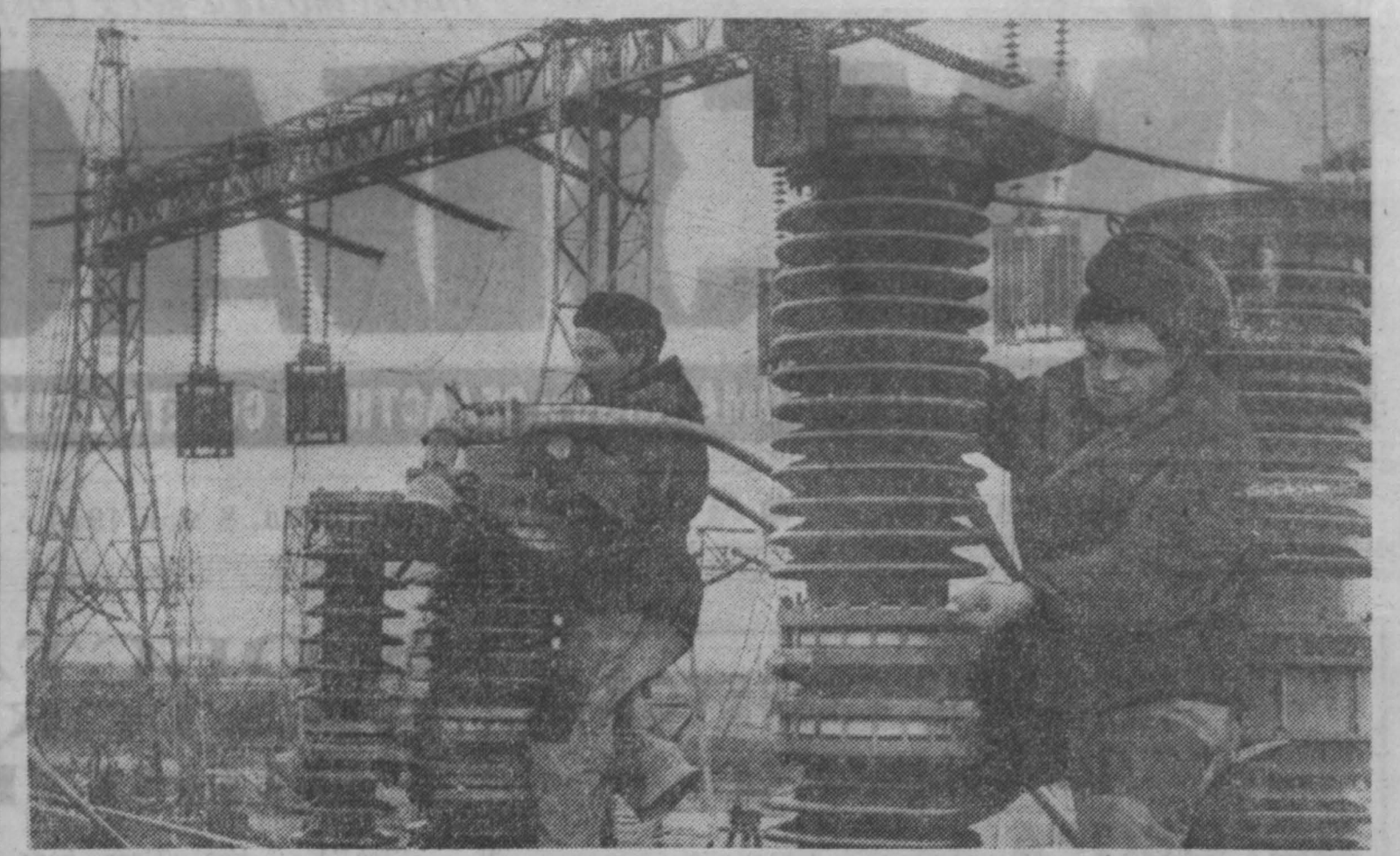
Строительство Ново-Анжерской подстанции в основном закончилось. И сейчас коллектив эксплуатационников проводит профилактические осмотры и ремонт сложной аппаратуры и всего обширного хозяйства. Всегда исправно несут службу электрослесари коммунист Александр Иванович Мазурков и Александр Яковлевич Саньков — хорошо знающие дело высококлассники. НА СНИМКЕ (слева направо): А. И. Мазурков и А. Я. Саньков за ремонтом воздушного выключателя. Фото К. Николаева.
