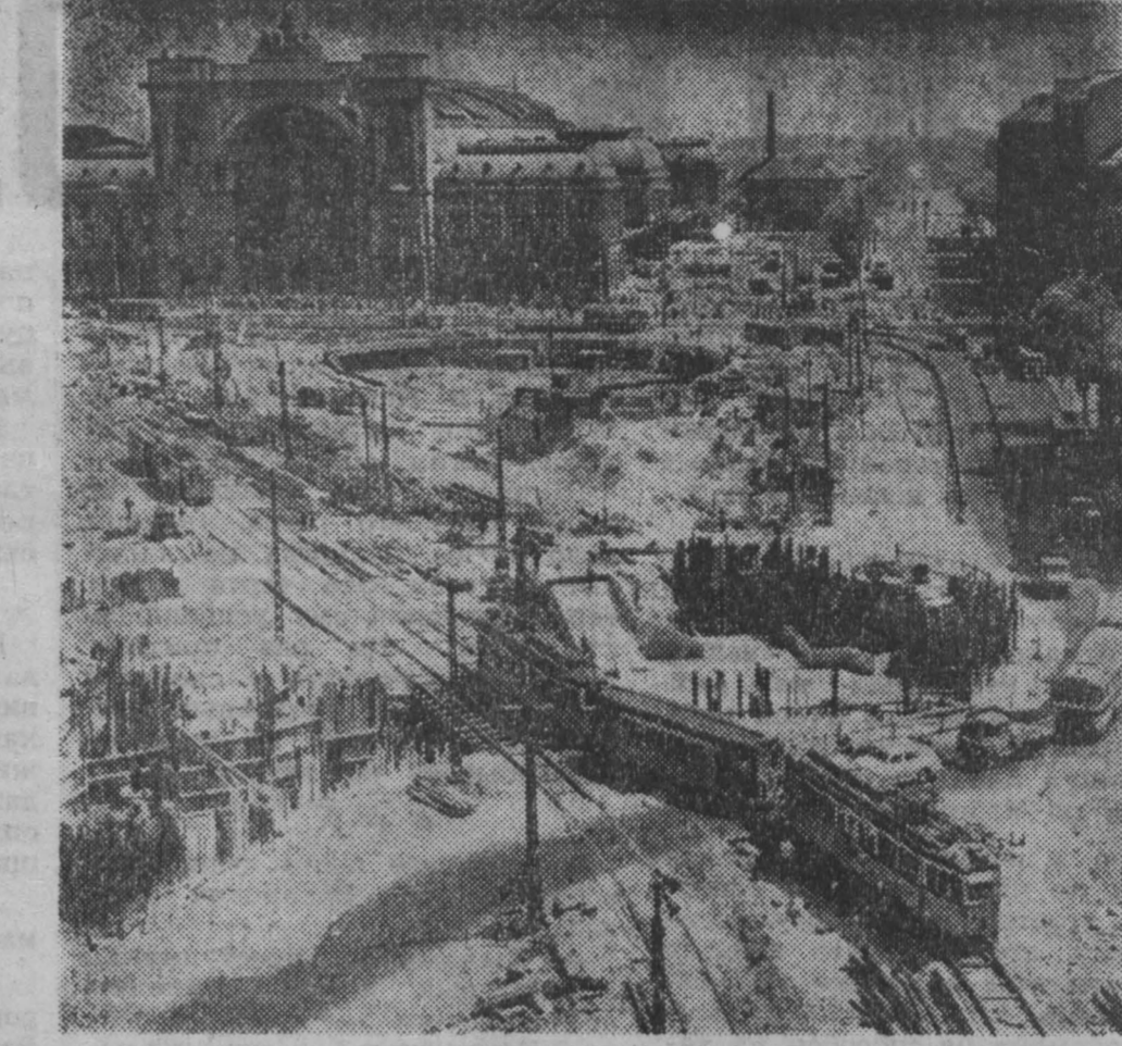
ВУДАПЕШТ. Венгерская столица реконструирует одну из своих центральных площадей — площадь Бароши. Напротив Восточного вокзала, рядом с одной из будущих станций метрополитена, создается сеть подземных переходов, благоустраиваются наземные транспортные пути.
