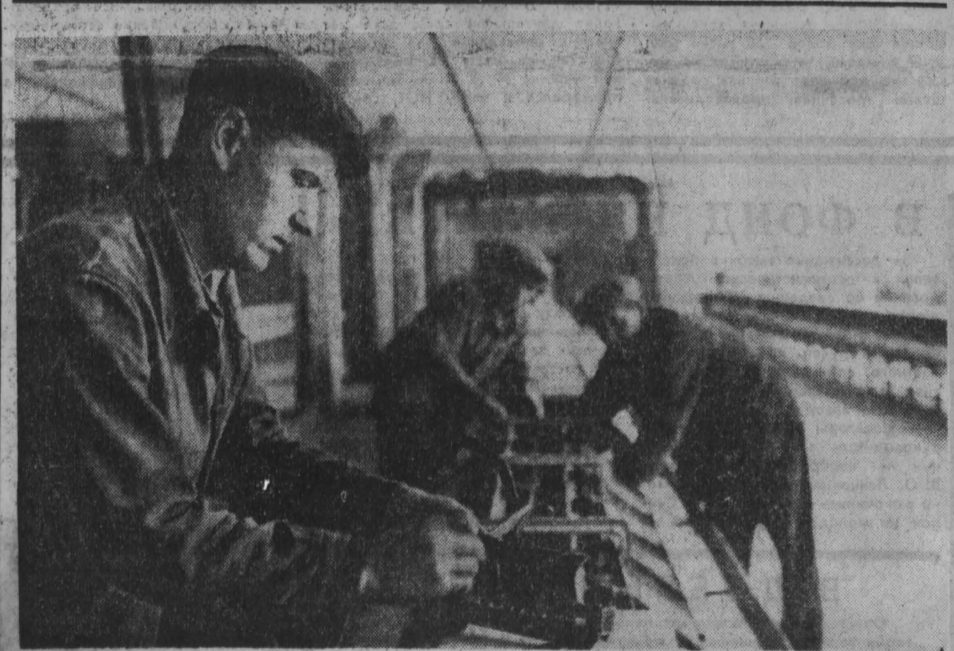
Киселевская обувная фабрика — пусковой объект нынешнего года. Сейчас здесь идут отделочные и монтажные работы. Коллектив строителей взял обязательство ввести фабрику в строй действующих досрочно. На монтаже оборудования отлачивается бригада Владимира Ивановича Косачева из треста «Сибметаллургомонтаж». На снимке вы видите бригадир В. Косачева и монтажников Л. Савина и И. Тимохина за надвальной конвейера. Фото П. Костюкова.
