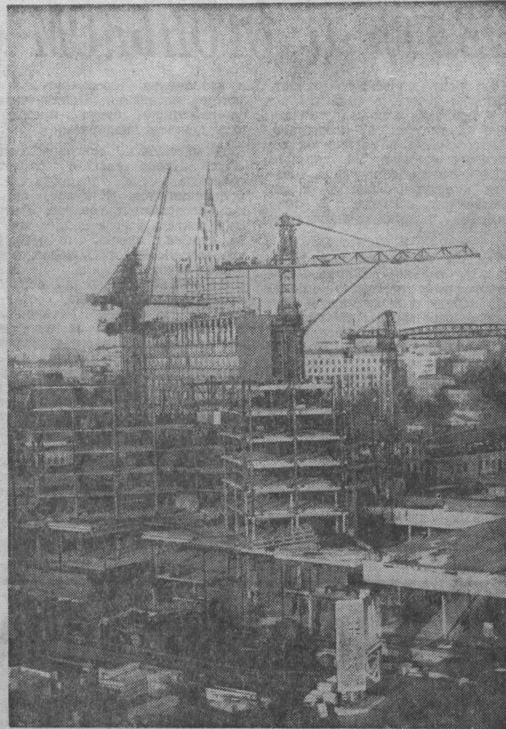
В Москве на проспекте Калинина возводится комплекс зданий Совета Экономической Взаимопомощи. Комплекс будет состоять из трех основных частей: административно-го 30-этажного корпуса, предназначенного для представительства стран — членов СЭВ, Секретариата и Института стандартизации, склада, в котором разместятся залы заседаний исполкома, конференц-зал и ресторан; 13-этажного корпуса, предназначенного для работников, приезжающих в Москву по делам СЭВ. Объем комплекса составит 800 тысяч кубических метров. В процессе строительства предстоит смонтировать по 4 тысячи тонн стальных конструкций, 300 тонн конструкций из алюминиевых сплавов. На снимке: строительное бюро комплекса зданий СЭВ на проспекте Калинина в Москве. Фото А. Сергеева-Васильева, АПН.
