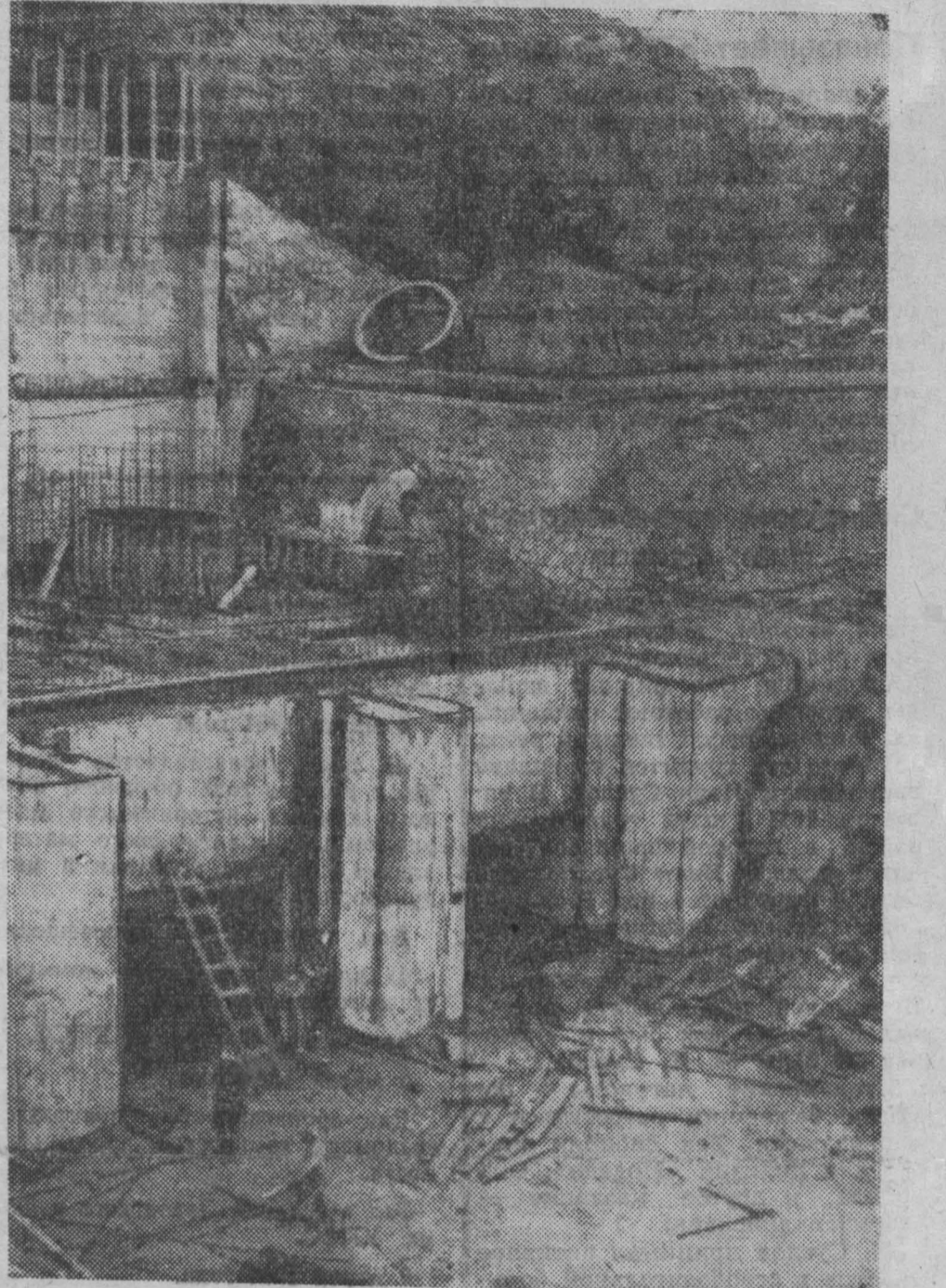
В Афганистане в районе города Джелал-Абад с помощью Советского Союза вступил в строй канал и гидроэлектрический комплекс, 70-километровый главный канал имеет устойчивость к напору воды в 30 тысяч гектаров. Фотография ТАСС.
