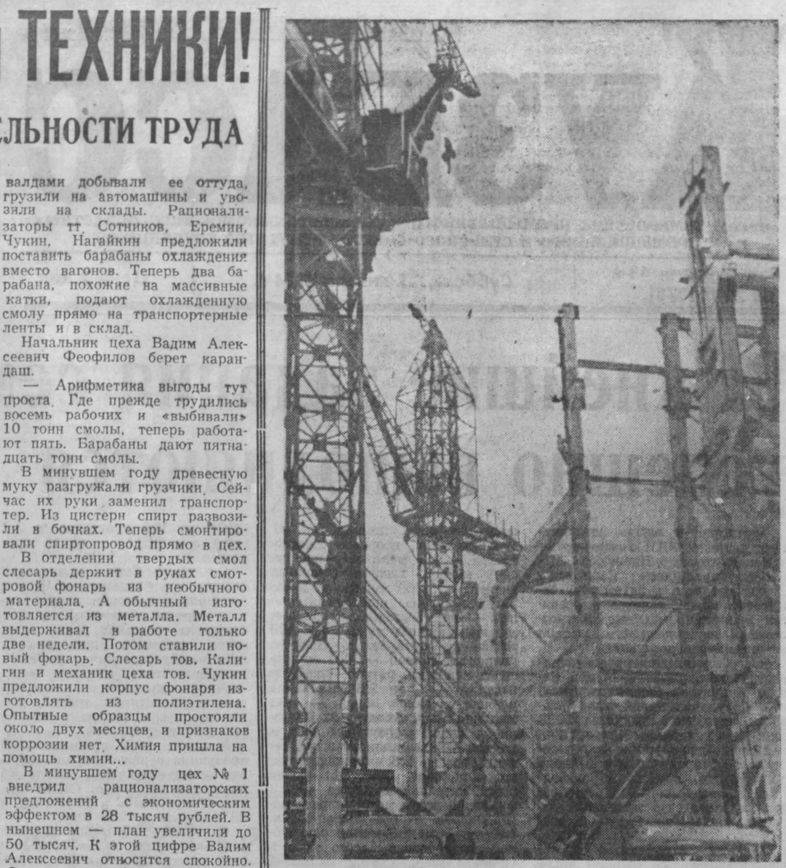
На Томь-Усинской ГРЭС получает путевку в жизнь седьмой блок. Считанные дни остаются до пуска в работу котла производительностью 640 тонн пара в час и турбины мощностью 200 тыс. киловатт.
