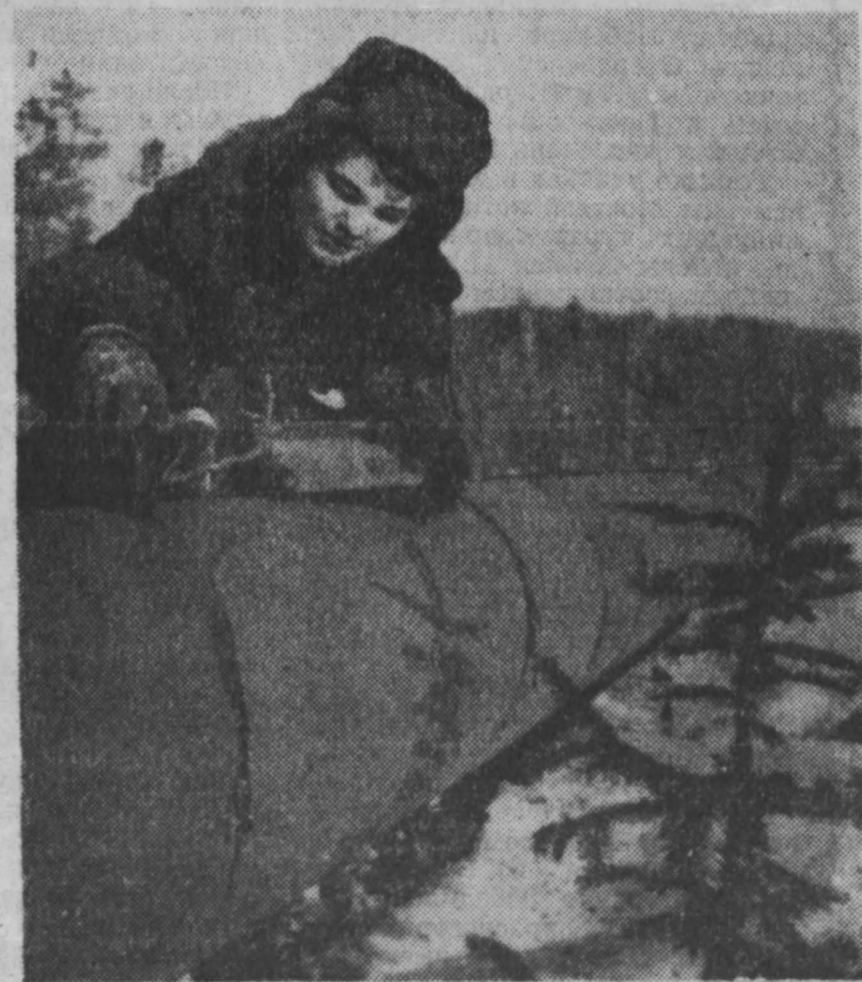
Надежно укутанная плотной изоляцией лежит шкура нефть-провода Оха—Комсомольск-на-Амуре. Техник-лаборант комсомольца Валентина Горбунова проверяет качество изоляции. Валентина строила газопровод Горький—Череповец, а теперь работает на дальневосточной земле.
