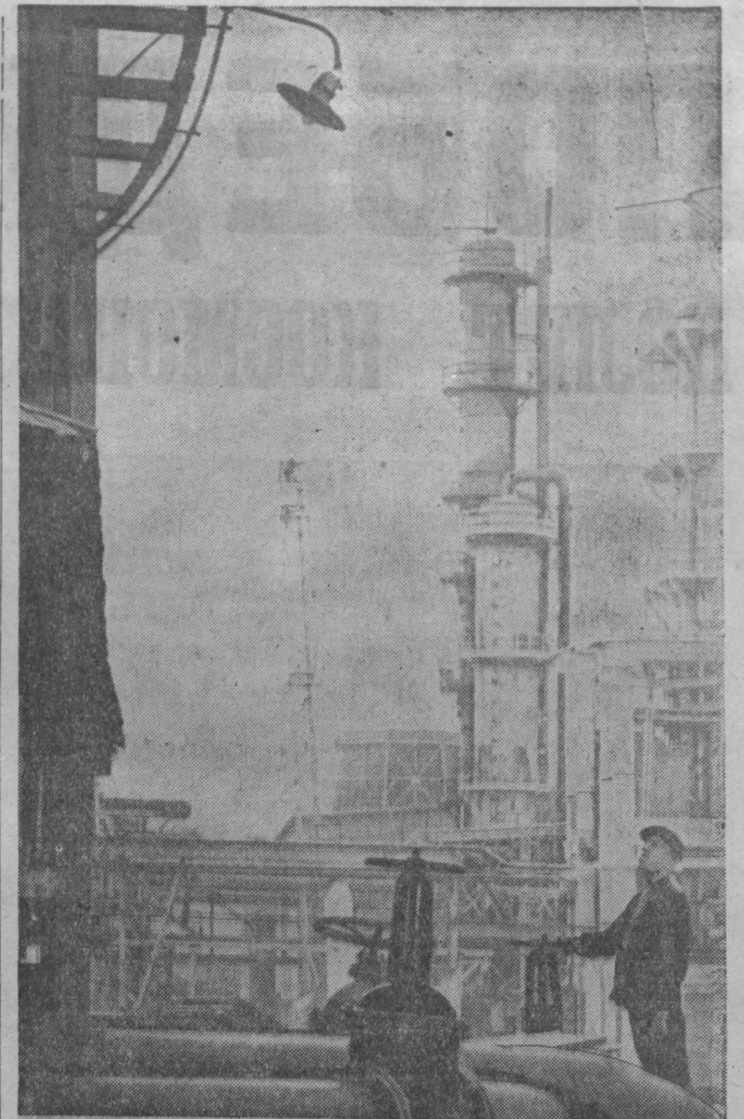
Пройдет немного времени, и в строй вступит еще один из пусковых объектов большой химии Кузбасса — цех дистилляции метанола Кемеровского химкомбината. Монтаж дестилляционных колонн и их обвязку в главном корпусе этого цеха ведут бригады прославленных мастеров — заслуженного строителя республики И. С. Алексеева и почетного строителя Министерства строительных и монтажных работ М. А. Афанасьева. НА СНИМКЕ: стройка цеха дистилляции метанола. Фото А. Кузурина.
