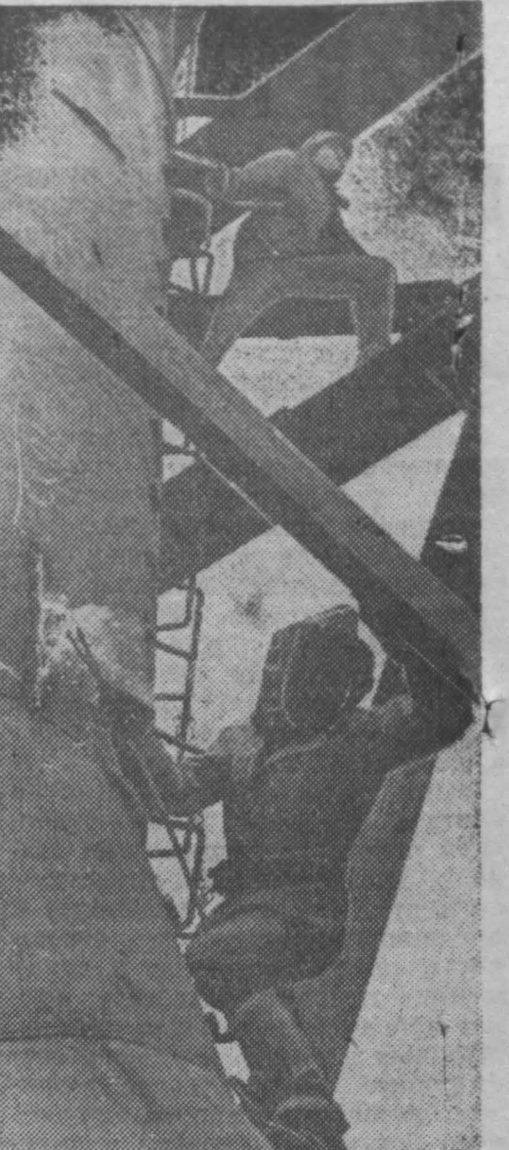
С каждым днем пириятся фронт работ на строительстве нового цеха черной металлургии — Западно-Сибирского завода. Патриоты, со всех концов страны приехавшие на ударную стройку семилетки, сооружают коксую батарею и доменную печь, строят электростанцию и новые жилые корпуса. На снимке вы видите монтаж металлоконструкций. Фото М. Владимирова.
