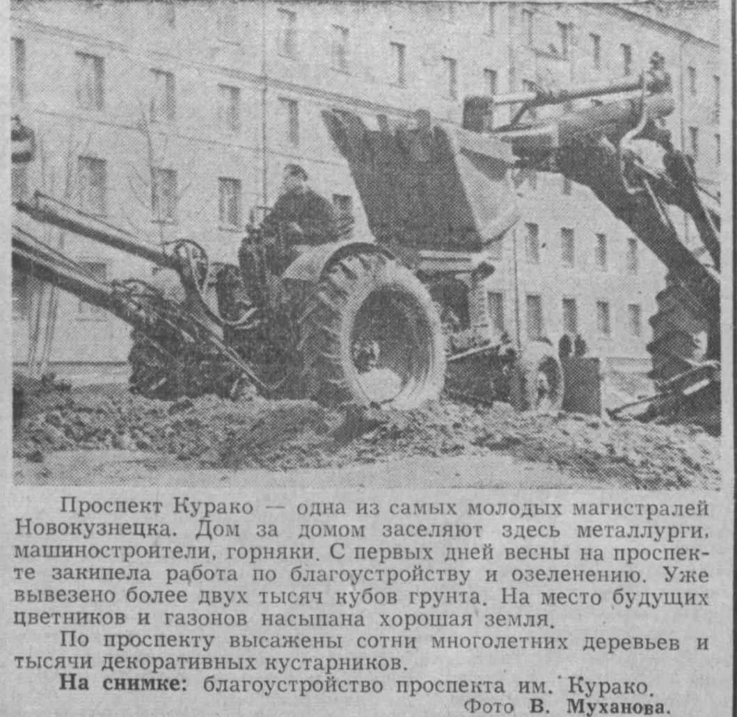
Проспект Курако — одна из самых молодых магистралей Новокузнецка. Дом за домом заселяют здесь металлурги, машиностроители, горняки. С первых дней весны на проспекте заняла работа по благоустройству и озеленению. Уже вывезено более двух тысяч кубов грунта. На место будущих цветников и газонов насыпана хорошая земля.
