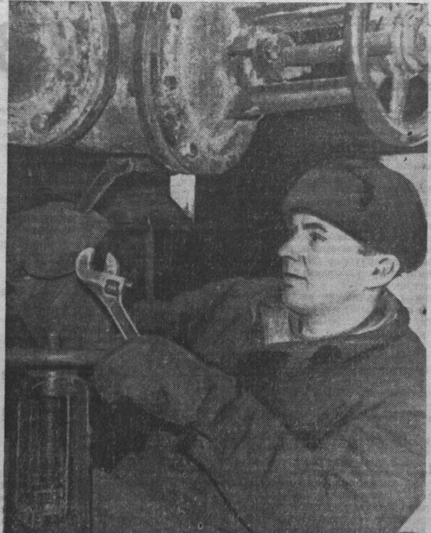
На ТЭЦ Запсиба монтируется оборудование. Теплоэлектростанция — пионерский объект нынешнего года. На этом снимке вы видите монтажника управления «Сибэнергомонтаж» Юрия Джумка. Молодой производственник занят монтажом установок химической и оптикой справляется с порученным делом. Фото В. Сизова.
