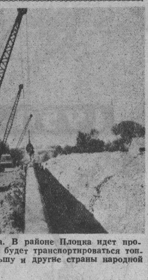
Польская Народная Республика. В районе Плоцка идет прокладка нефтепровода, по которому будет транспортироваться топливо из Советского Союза в Польшу и другие страны народной демократии.
