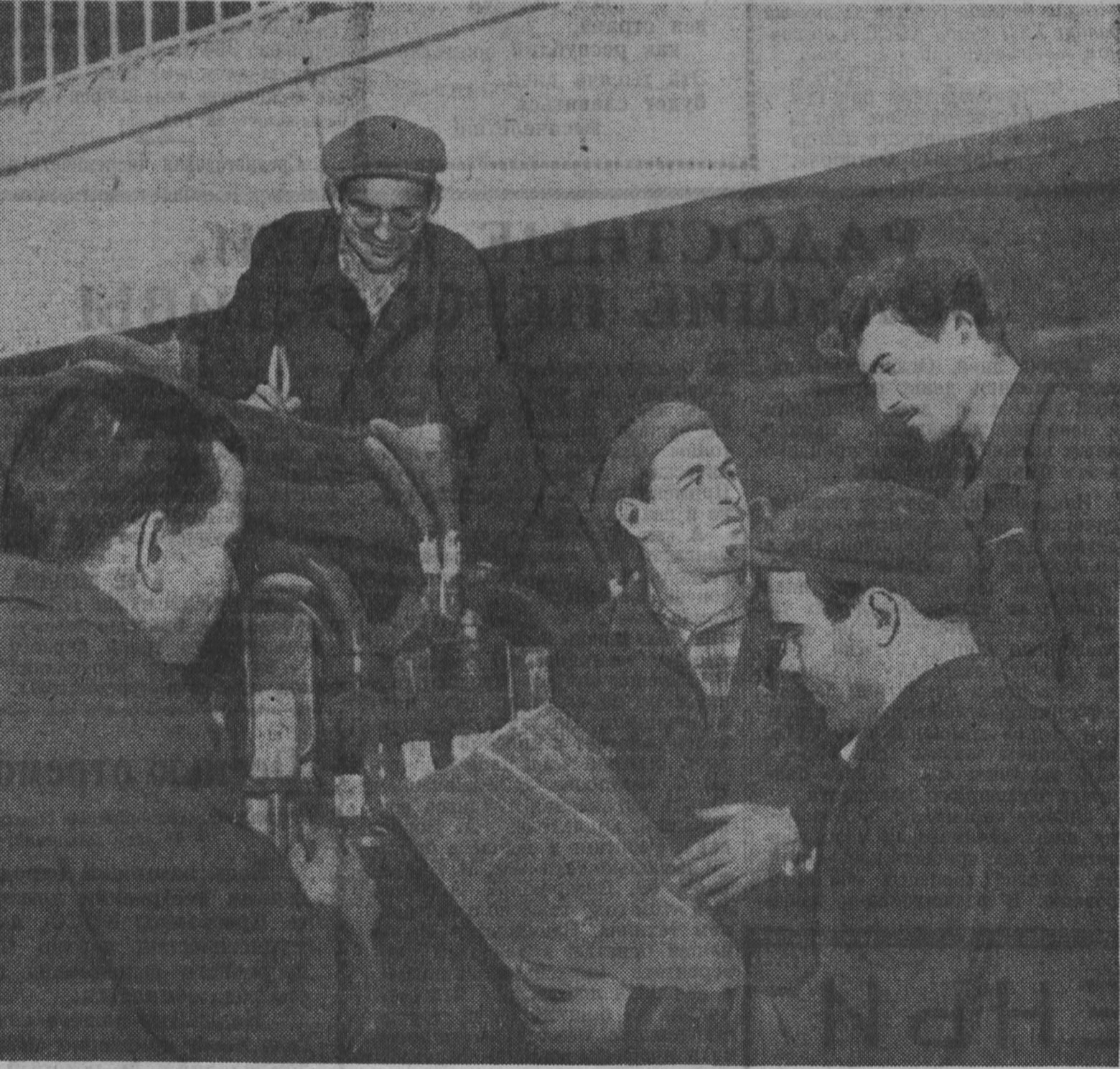
Успешно несет предельно высокую нагрузку на строительстве Сталинского алюминиевого завода бригада наладчиков ртуть-преобразовательной подстанции, которую возглавляет Николай Степанов. Молодежь борется за досрочное выполнение своих обязательств.
