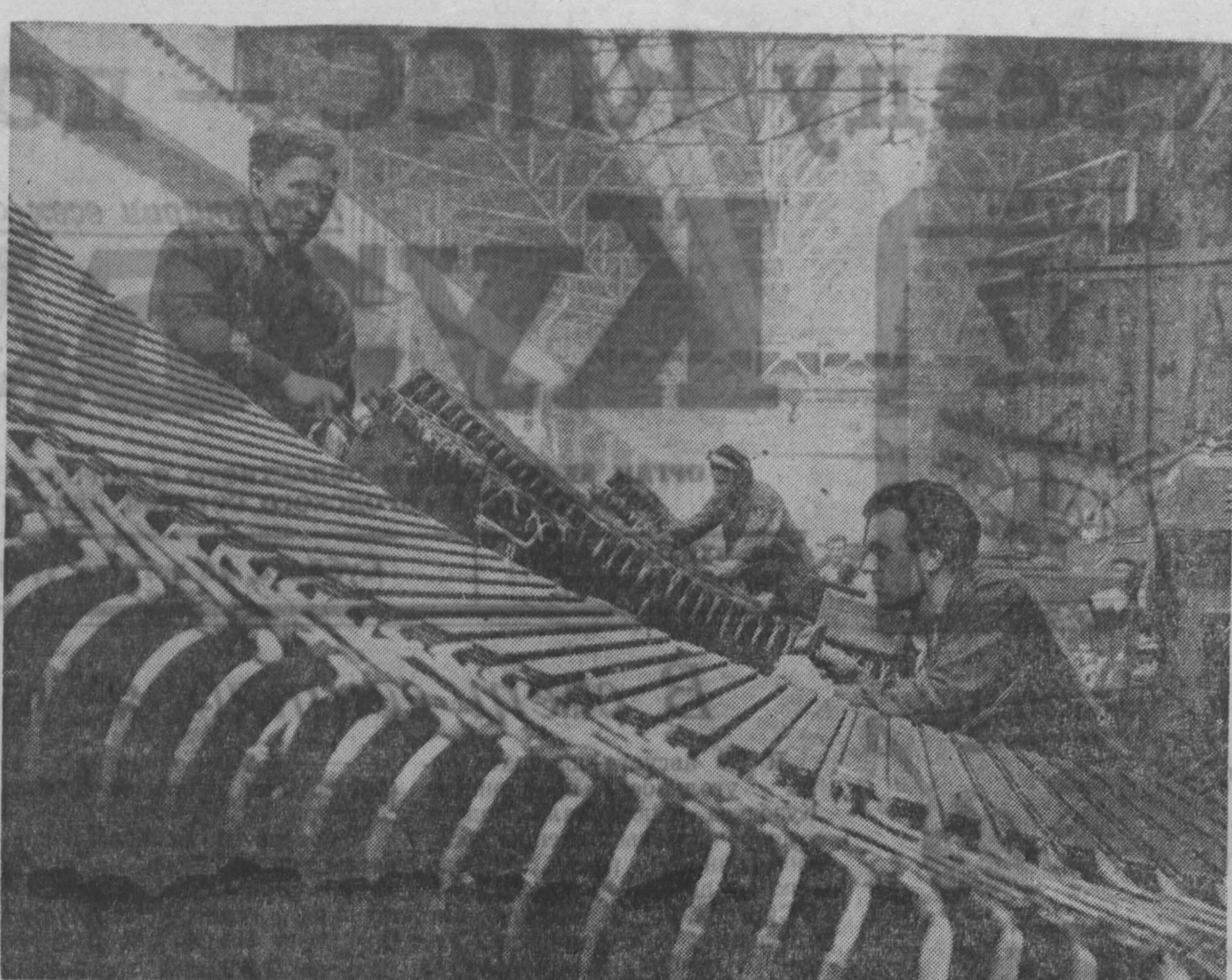
ЛЕНИНГРАД. Коллектив гидрокорпуса завода «Электросила» имени С. М. Кирова готовит достойную встречу XXII съезду КПСС. НА СНИМКЕ: рабочие И. М. СУЕТОВ (слева) и А. А. ЛУЖИН ведут обмотку статора уч-курского гидротурбинного агрегата.
