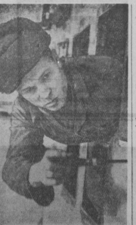
Электрослесарь цеха «Востокмонтажмашин» В. Ф. Карцев ведет монтаж и установку контрольно-измерительных приборов и автоматов на домашних кузнечных комбинатах.
