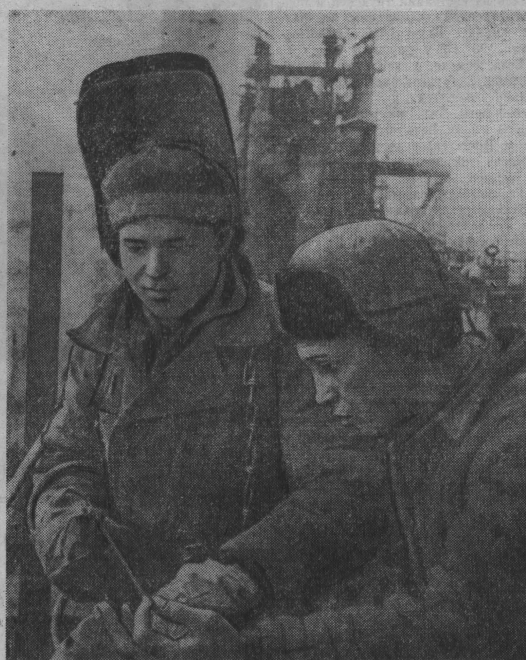
В дни монтажа основного оборудования Кузнецкой-комсомольской долины рабочей бригады «Стальмонт-3» Альберт Вайверов выполнял задания на 250—300 процентов. Сейчас у него тоже дело горячее: сварка металлических перил — ведь долму-то скоро сдавать!
