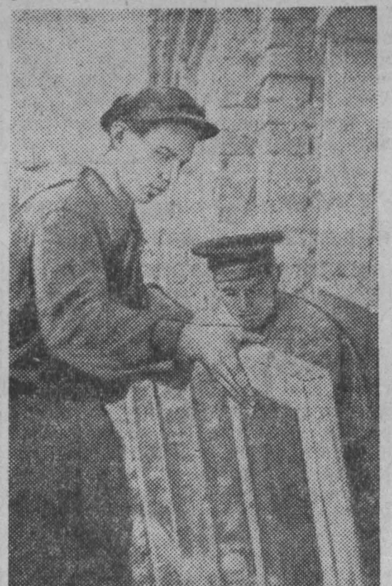
Чтобы вырастить пятьдесят тысяч утят, нужны просторные пехи. На строительстве батарейного пеха отлично трудятся Александр Колобков (слева) и Геннадий Белообородов.
