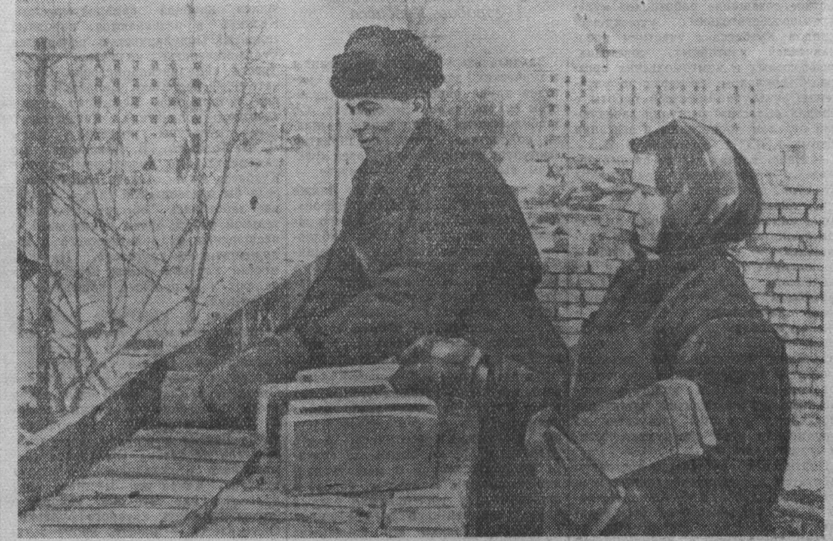
На строительстве жилого дома по улице Весенней в Кемерове хорошо трудится бригада каменщиков А. Б. Антонова. В ней работает 21 человек, большинство строителей — молодежь. Однако это не мешает коллективу добиваться высоких показателей. В декабре, например, бригада выполнила задание на 170 проц. НА СНИМКЕ: каменщики Д. И. ЛЮБКИН и комсомолец Валентина ЗОЛУТХИНА на площадке здания. Фото П. Костюкова.
