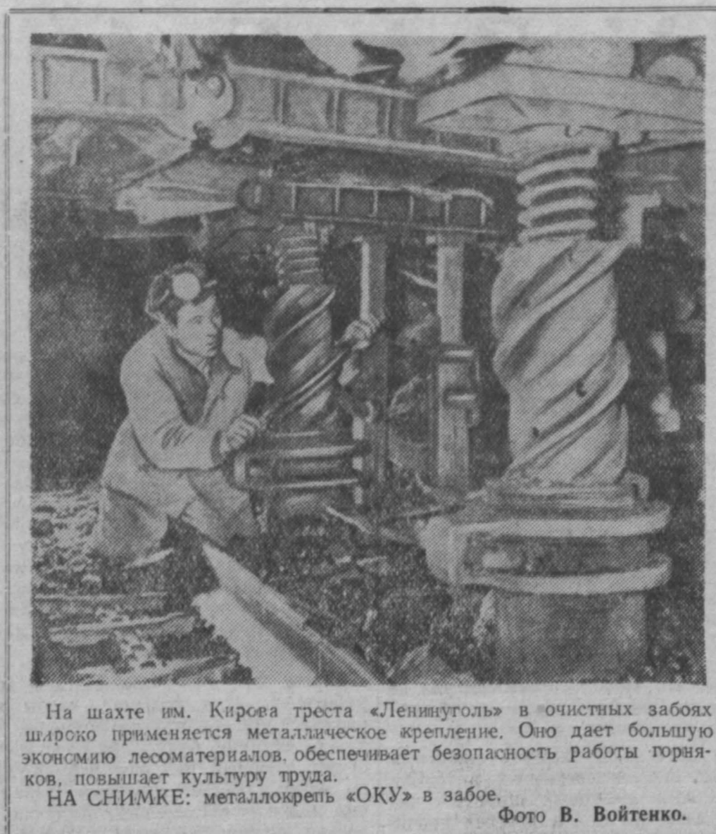
На шахте им. Кирова треста «Ленинуголь» в очистных забоях широко применяется металлическое крепление. Оно дает большую экономию лесоматериалов, обеспечивает безопасность работы горняков, повышает культуру труда. НА СНИМКЕ: металлокрепь «ОКУ» в забое. Фото В. Войтенко.
