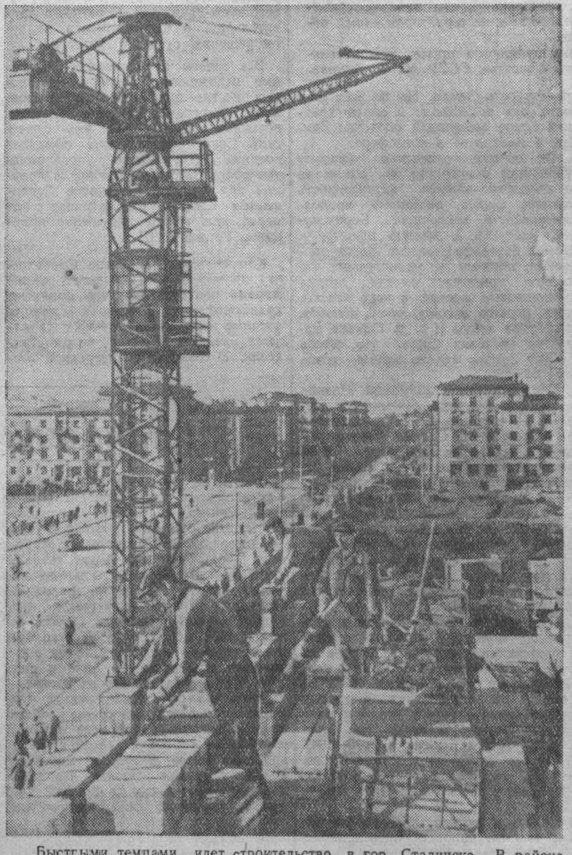
Быстрыми темпами идет строительство в гор. Сталинске. В районе «Треугольника», на проспекте Молотова, на улицах Куйбышева и Орджоникидзе видны леса новостроек. НА СНИМКЕ: строительство жилого дома на проспекте Молотова. Кладку ведет бригада каменщиков, возглавляемая МЕЩЕРЯКОВЫМ. Фото В. Скоробогатова.
