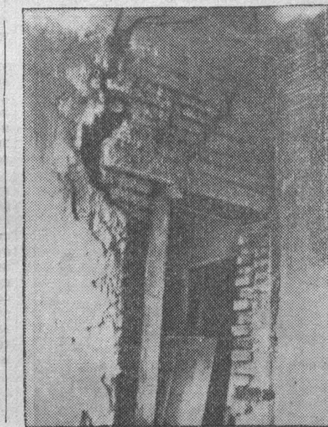
На этом снимке вы видите внутреннюю стену одного из домов, построенных Анжерским строуправлением в поселке шахты «Андреевская-3». Зимой фундамент дома был заморожен, а весной в стенах здания появились трещины, достигшие ширины 150 миллиметров.
