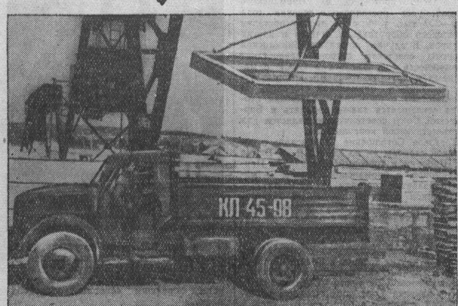
Коллектив треста «Стальскпромстрой» сооружает в подшефном колхозе имени Фрунзе, Кузнецкого района, две сильные тракторы на железобетонных панелях перекрытий. Это будут высококачественные и долговечные сооружения. НА СНИМКЕ: отгрузка панелей на заводе строителей для отправки их в колхоз. Фото Г. Преснякова.
