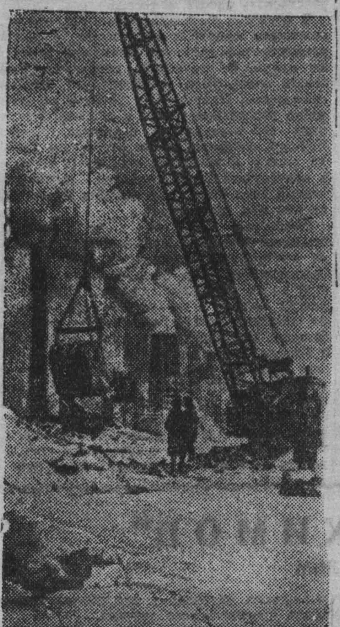
На строительной площадке 6-й коксовой батареи Кузнецкого металлургического комбината имени И. В. Сталина. Фото В. Пушкина.
