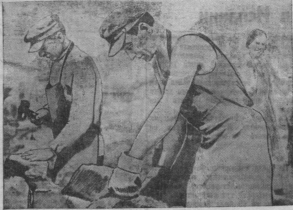
На снимке: комплексная бригада каменщиков тов. Галамова (5-й строительный участок Кемтяжстроя) за работой. Бригада систематически перевыполняет норму выработки на кладке фундамента на 180—200 проц.
