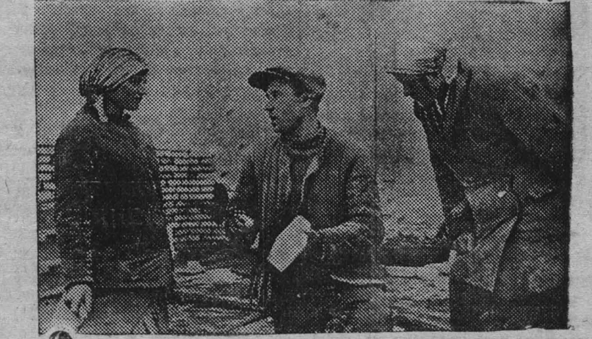
Лучший стахановец на стройке соцгорода Сталиногорска каменщик тов. Спиренко выполняет норму на 300 проц. и успешно передает свой опыт товарищам по работе. На снимке: (в центре) тов. Спиренко делится своим опытом с подсобными работницами т. Блаудиной (справа) и т. Волковой (слева).
