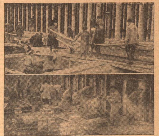
НА СНИМКЕ: Воскресник в день обороны на строительстве третьей батареи коксовых печей.
