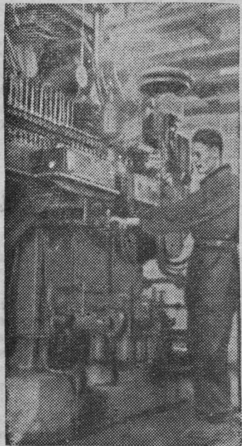
Газопровод Саратов—Москва Главная компрессорная станция № 1.
